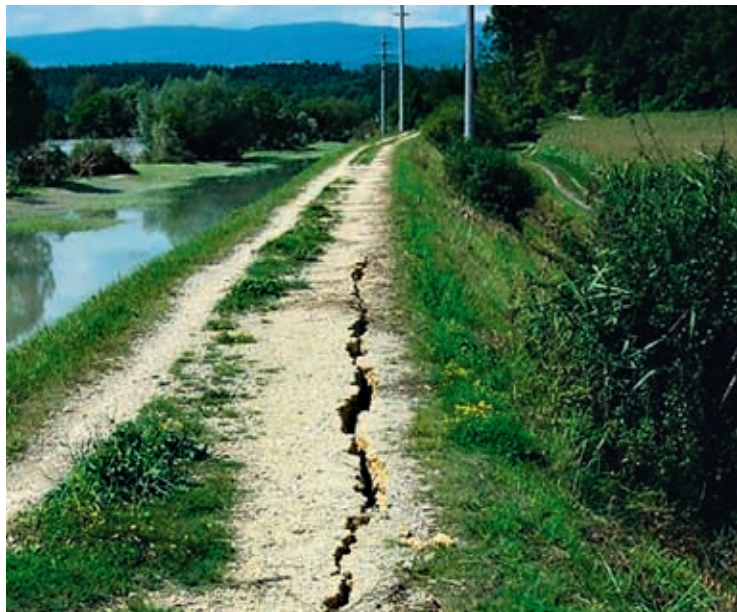
Risse im Damm: Bereits das Hochwasser von 2005 brachte den Hagneckkanal an die Grenzen seiner Belastbarkeit. (Foto Werner Könitzer)
